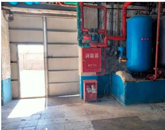
车间消防设施
