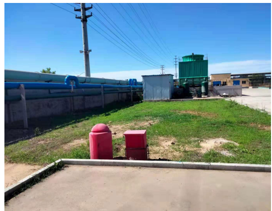
厂区消防设施
